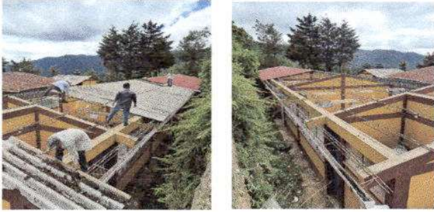
Foto1: Módulo 2, Sustitución de lámina por lámina troquelada, sustitución de capote y sustitución de elementos de fijación.
